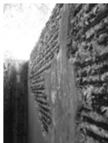
koroze betonářské výztuže
