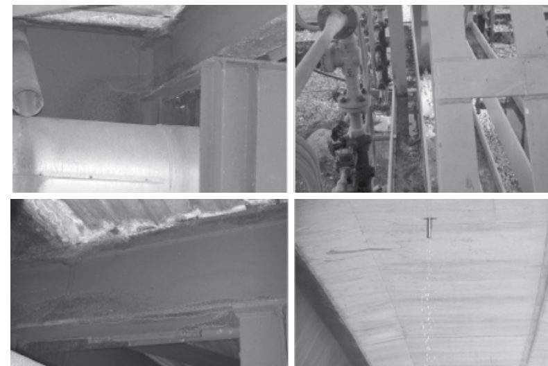
Obrázek 6 – Nevhodné řešení konstrukce – odvod srážek, zádrž vody, zatékání
