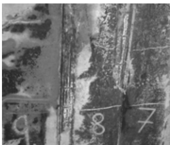
koroze předpínací výztuže
