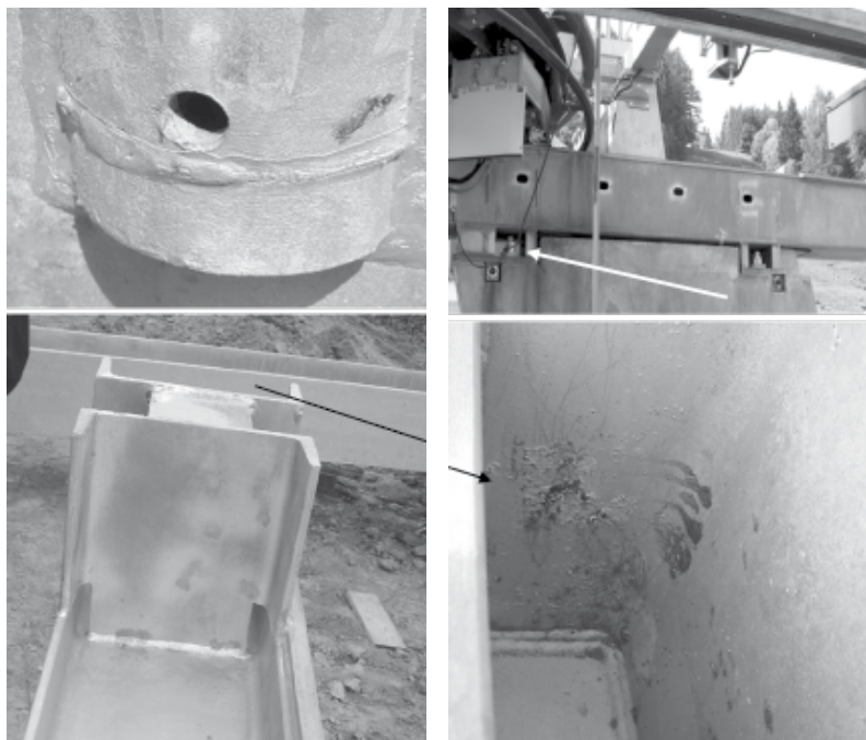
Obrázek 8 – Rozměrné a složité konstrukce nevhodné pro žárové zinkování ponorem
