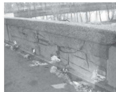
Obr. 4 Poškozená výplň zábradlí
