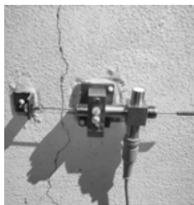
měření posuvu na trhlině
