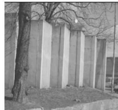
Obr. 1 Postupně chátrání starší i novější betonové konstrukce ve vnějším prostředí
