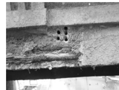
odběr vzorků z poškozeného trámu
