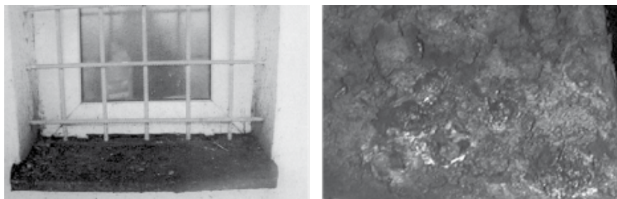
Obrázek 3 – Korozní napadení měděných parapetů na objektu ČOV
